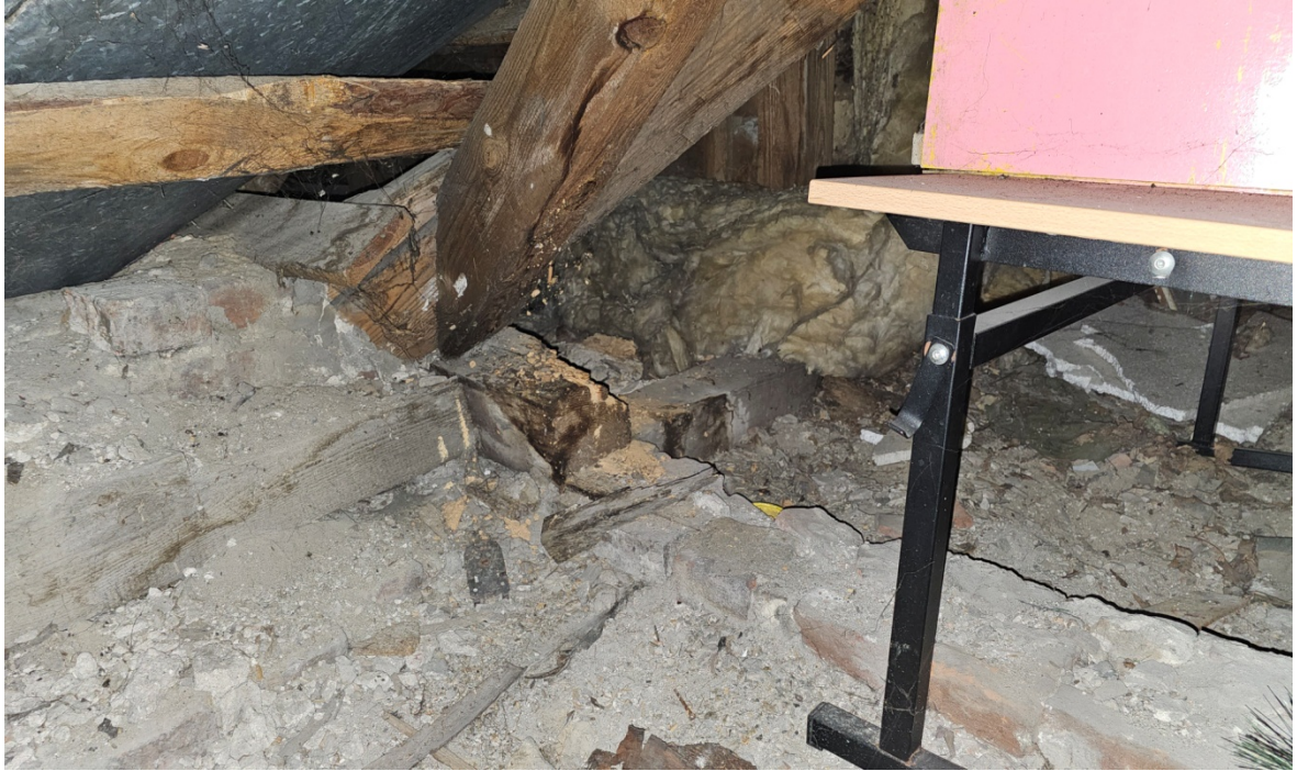
Fot. 9 Widok łączenia krokwi z murłatą – liczne ślady korozji biologicznej (grzyby pleśniowe, widoczne otwory po szkodnikach drewna, wilgoć).
