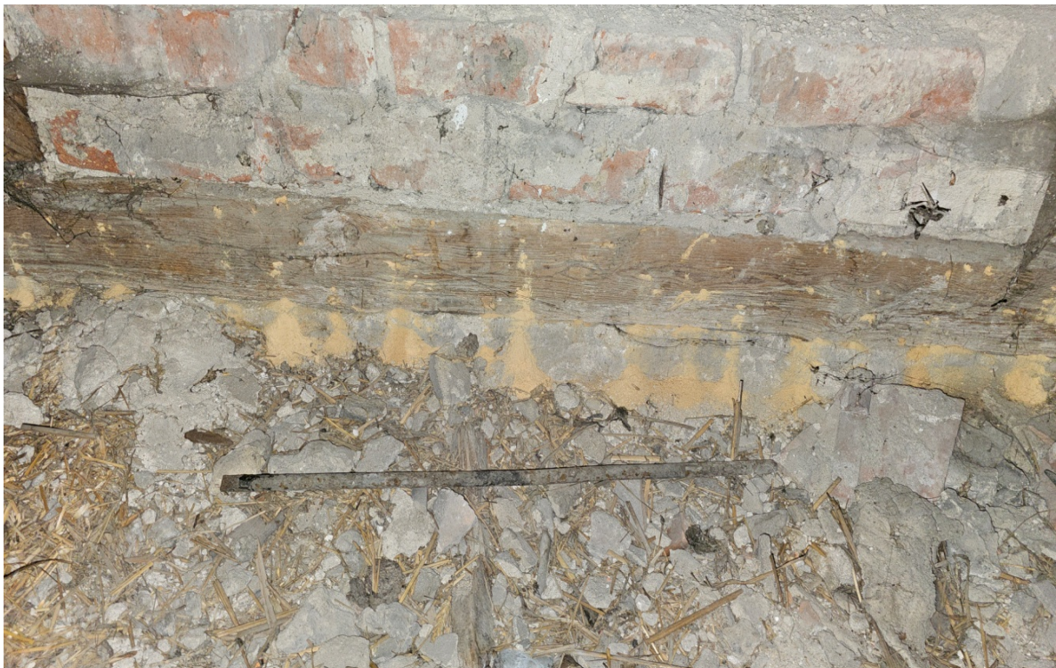
Fot. 10 Widok łączenia murłaty ze ścianką kolankową – liczne ślady korozji biologicznej (widoczne trocinki wysypujące się z otworów wylotowych po szkodnikach drewna).
