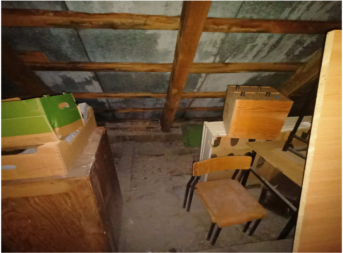
Fot. 7 Widok na elementy konstrukcyjne dachu – liczne ślady korozji biologicznej, przecieki pokrycia dachowego.
