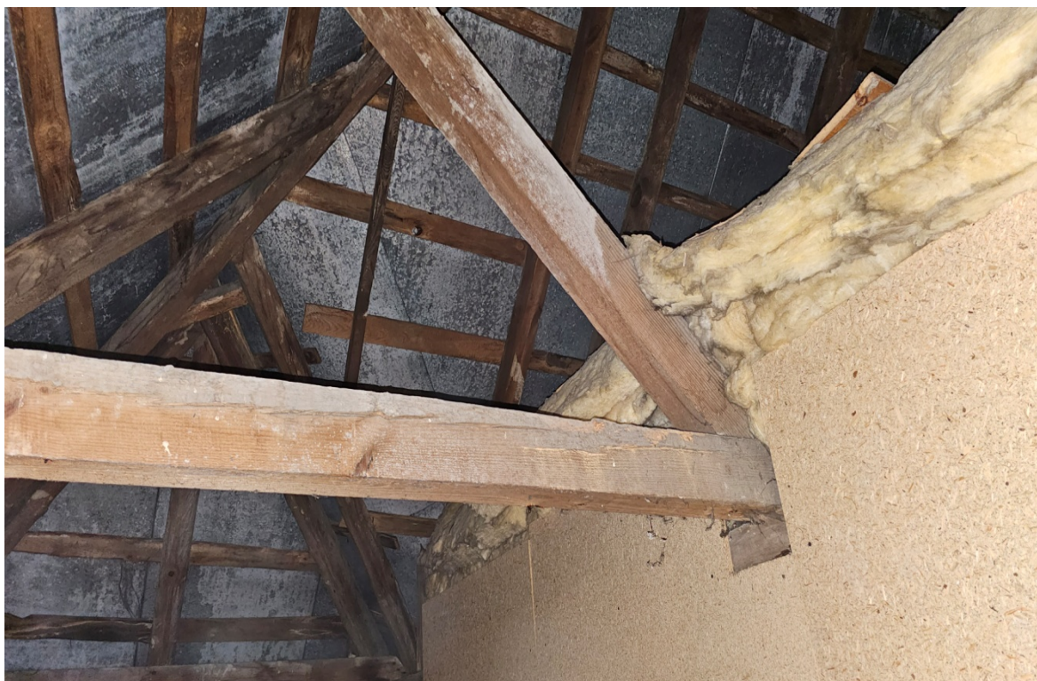
Fot. 11 Widok na porażone elementy konstrukcyjne jętki – liczne ślady korozji biologicznej (widoczne spękania, odspojenia drewna).
