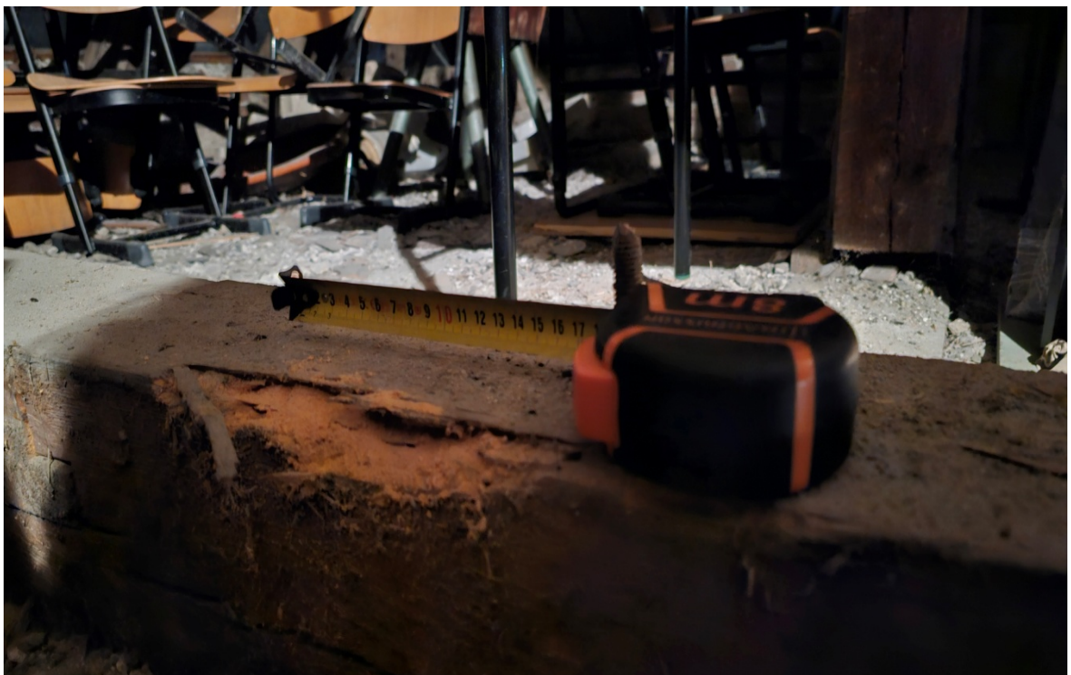
Fot. 8 Podciąg zwany tramek w stropie poddasza – liczne ślady korozji biologicznej, otworów po szkodnikach drewna (spuszczel pospolity, kołatek domowy).
