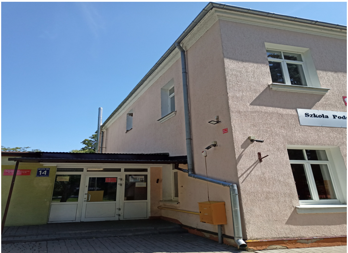
Fot. 2 Widok na wejście do szkoły – poprzez łącznik od strony zachodniej, oraz na elewację północną budynku. Widać liczne ślady korozji, na obróbce blacharskiej cokolika.
